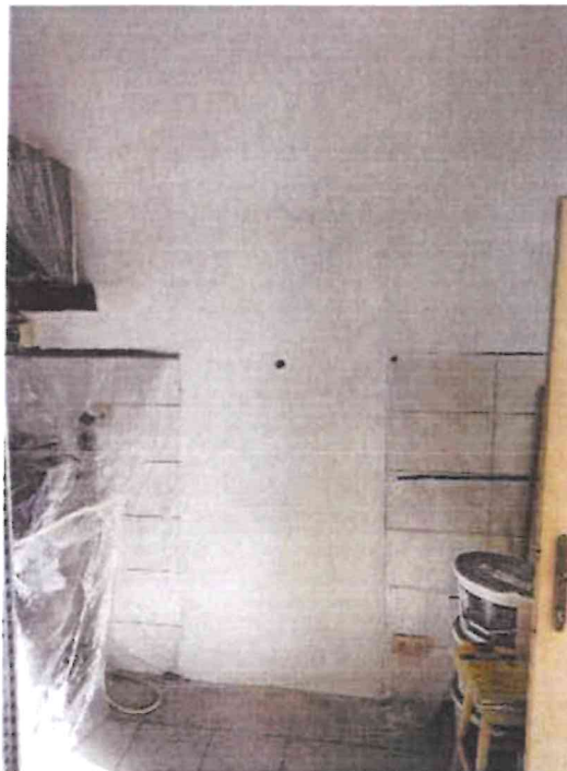
Pohled na dodatečně zřízený a následně zazděný otvor - pohled směrem z kuchyně
