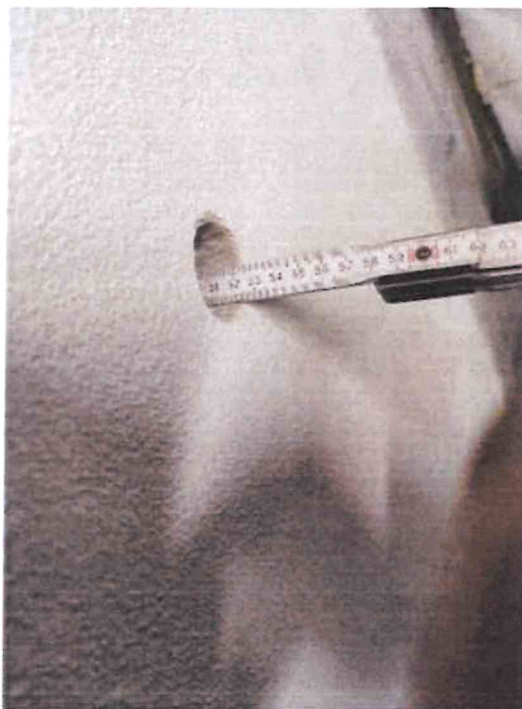
Pohled na sondu dodatečně zazděným otvorem - tloušťka zadržky včetně vzduchové mezery
